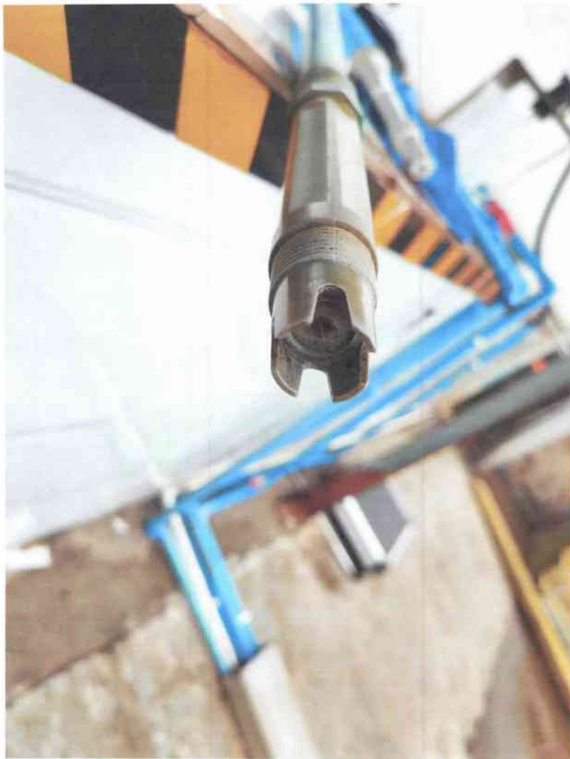
附件 1 pH 在线仪玻璃电极球泡损坏照片
